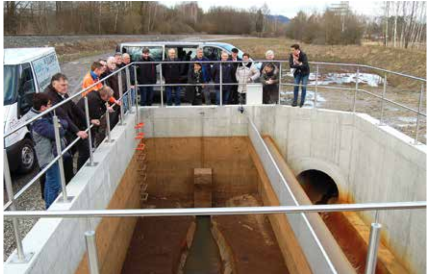
Die Verbandsräte besichtigten das neu gebaute Regenüberlauf- und Regenrückhaltebecken Ziegelholz, wozu Technische Leiterin Sabine Eichinger (rechts) Ausführungen machte. Foto und Text: Werner Artmann, Mittelbayerische Zeitung
